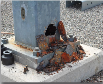
Columna dañada por corrosión.
