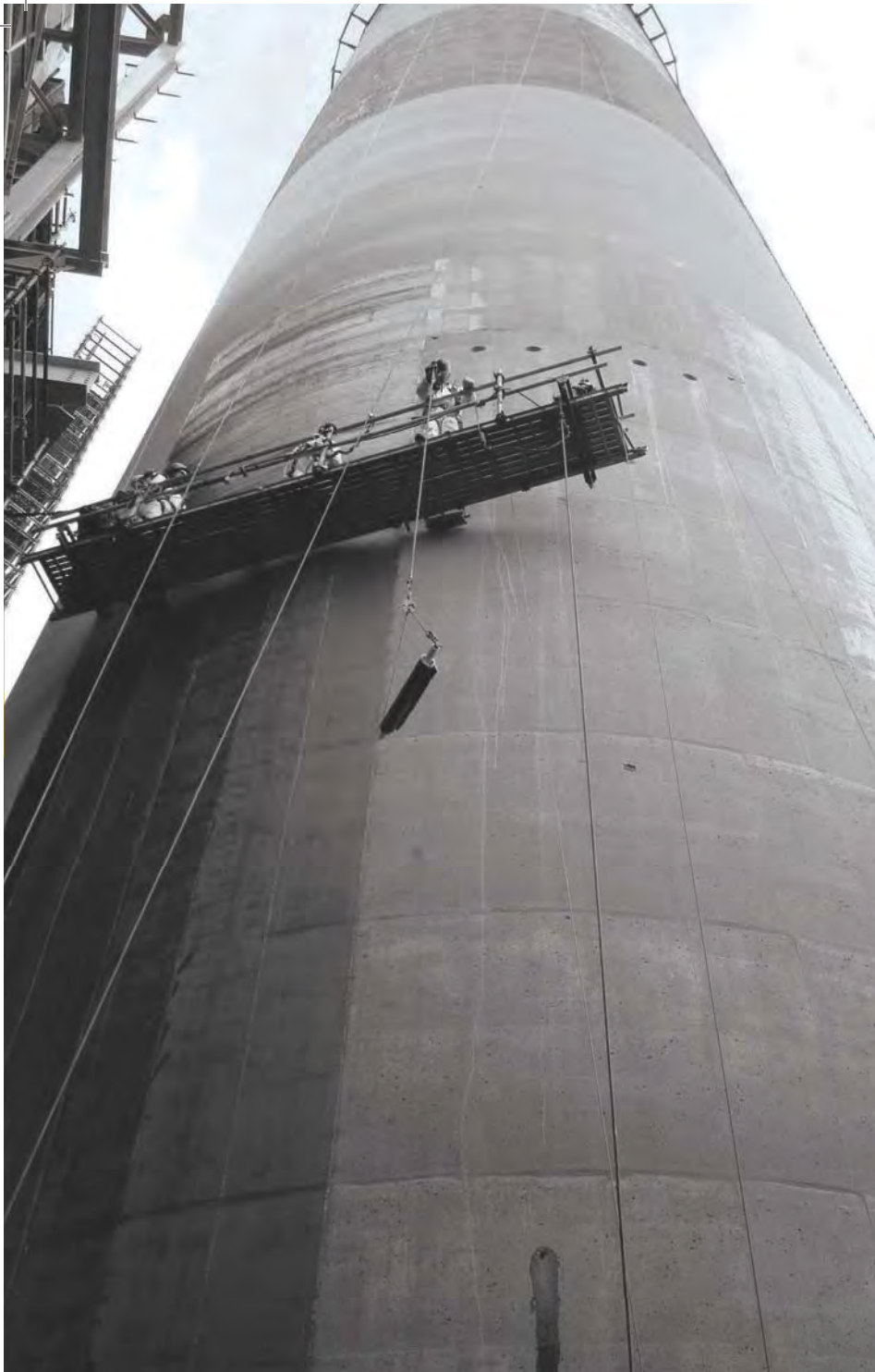
REFUERZO DE FRP ANTES DE CORTAR UNA APERTURA DE 12'X74' EN LA PARED DE LA CHIMENEA INDUSTRIAL EN MOBILE, AL.
