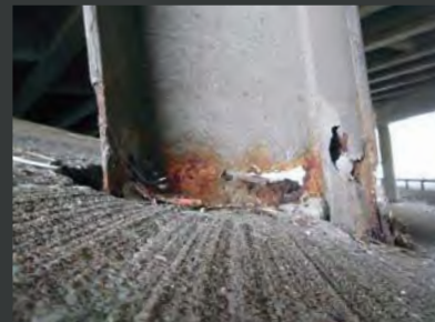
Pilares H con una gran pérdida de sección debido a la corrosión.
