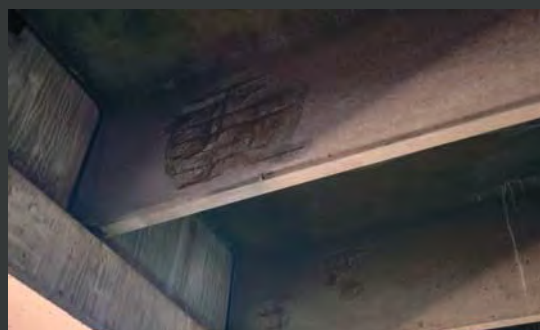
VIGA DE CONCRETO DAÑADA.
